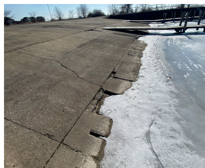
Uneven concrete ramp
